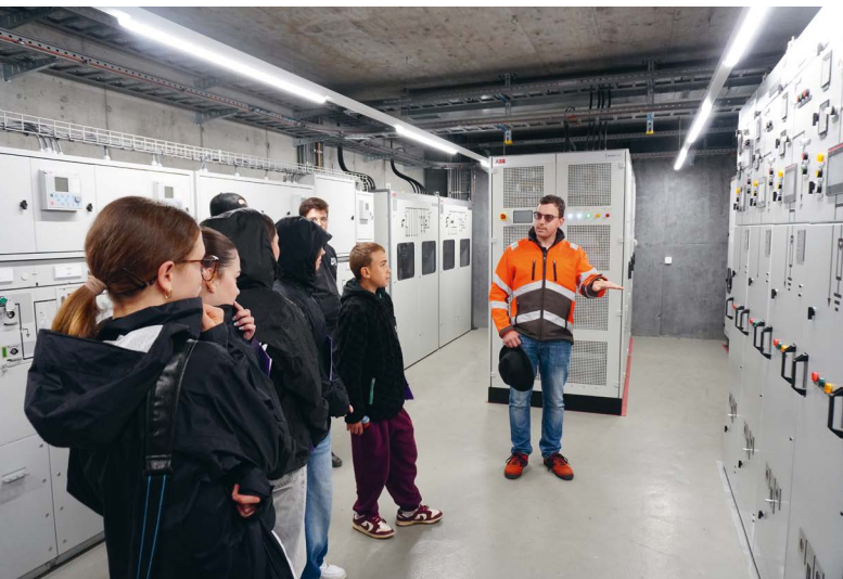
Explications sur le fonctionnement de la sous-station des TMR
