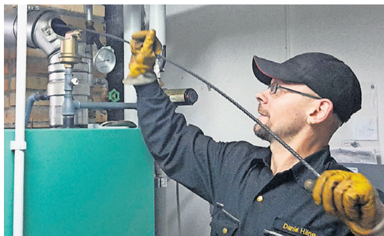
Neben der Wartung von Heizanlagen ist der Kaminfeger auch Energieberater.
